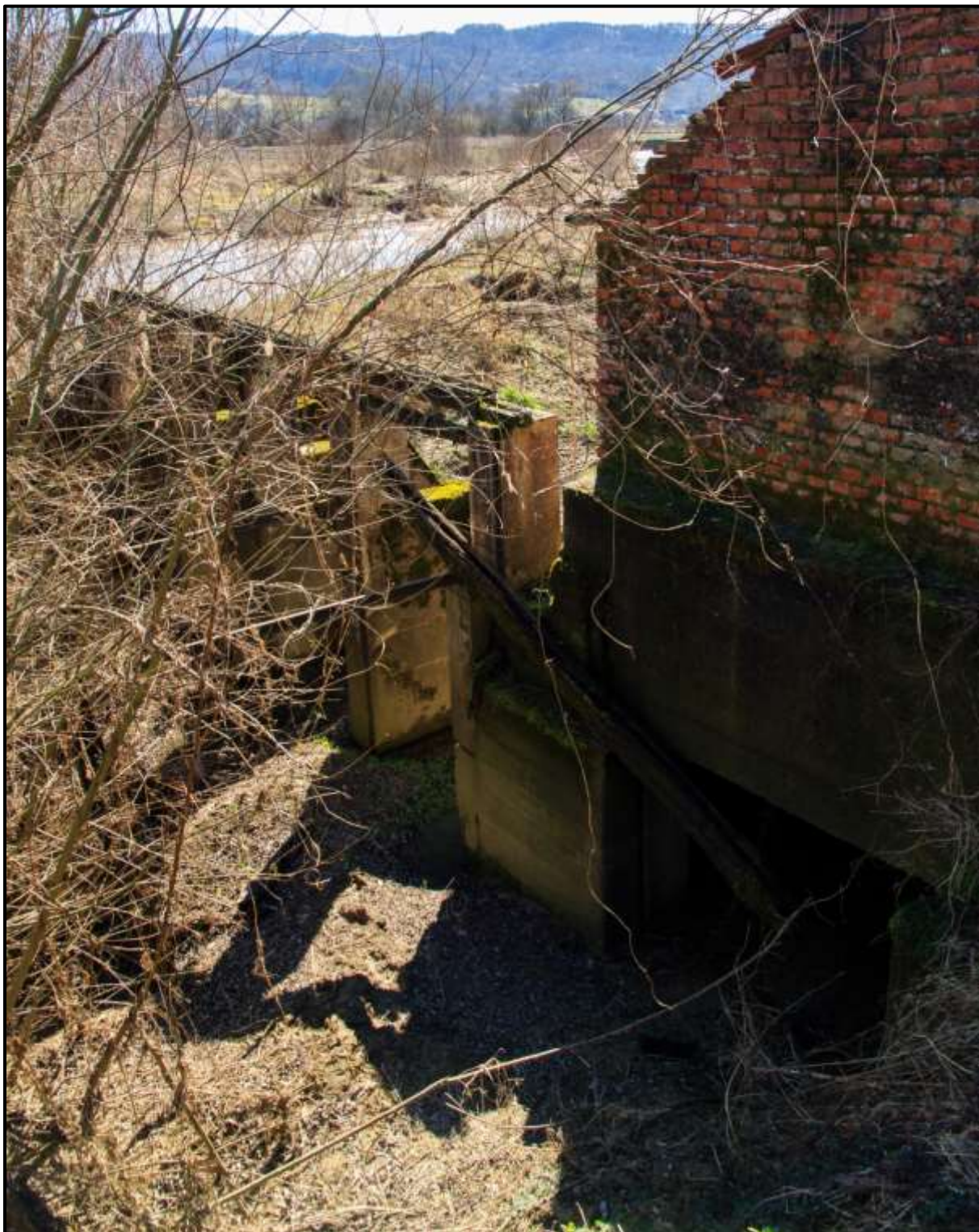
Slika 35 Stanje ustava - Štajduharov mlin. Nanesen taložni materijal i obraslo samoniklom vegetacijom.
